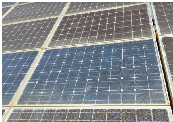
Figure 2. 8: Détérioration du revêtement antireflet (ARC)
