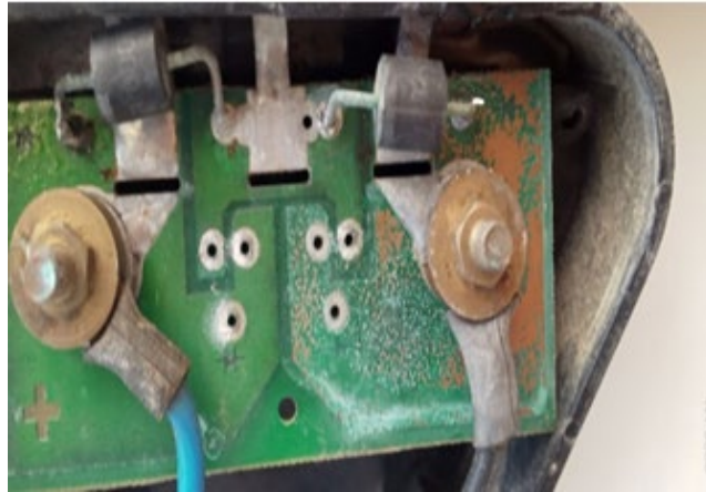
Figure 2. 11: Défaut de la diode Bypass.
