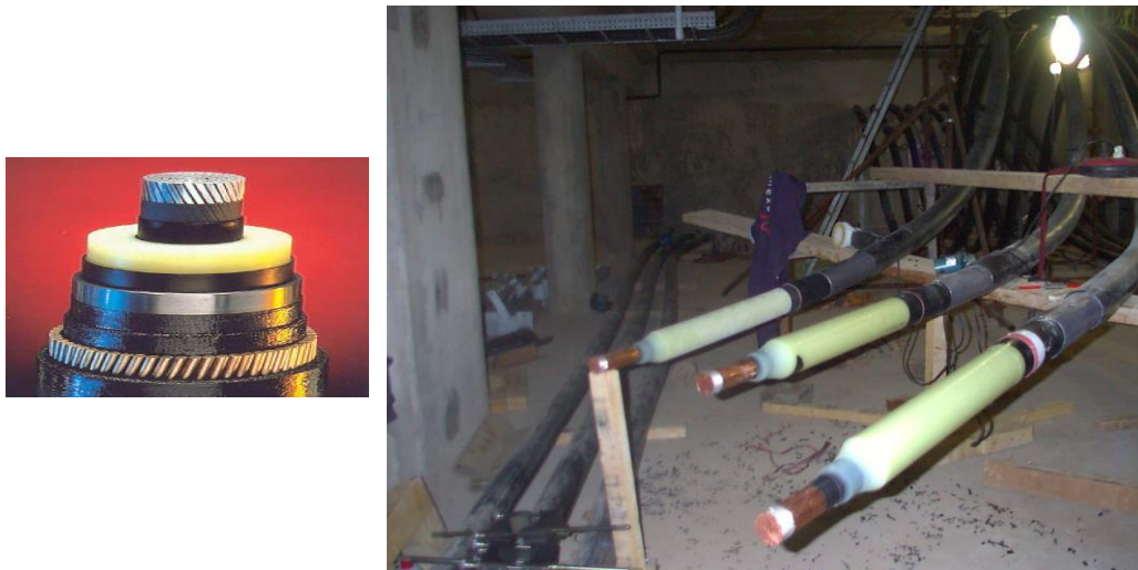
Figure 1.2: Câble réel utilisé dans les nouvelles centrales Algériennes.
