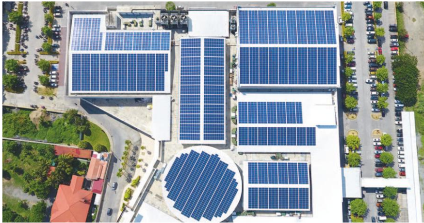
Figure 1.8. Système PV monté en toiture d'un immeuble commercial en Philippines.
