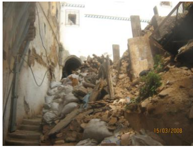
Vide à l'angle de la rue Amokrane Med et Ali Lahmar chargé de débris et de gravats – Photo prise en 2012 (Source CEAT El Medina, 2022)
