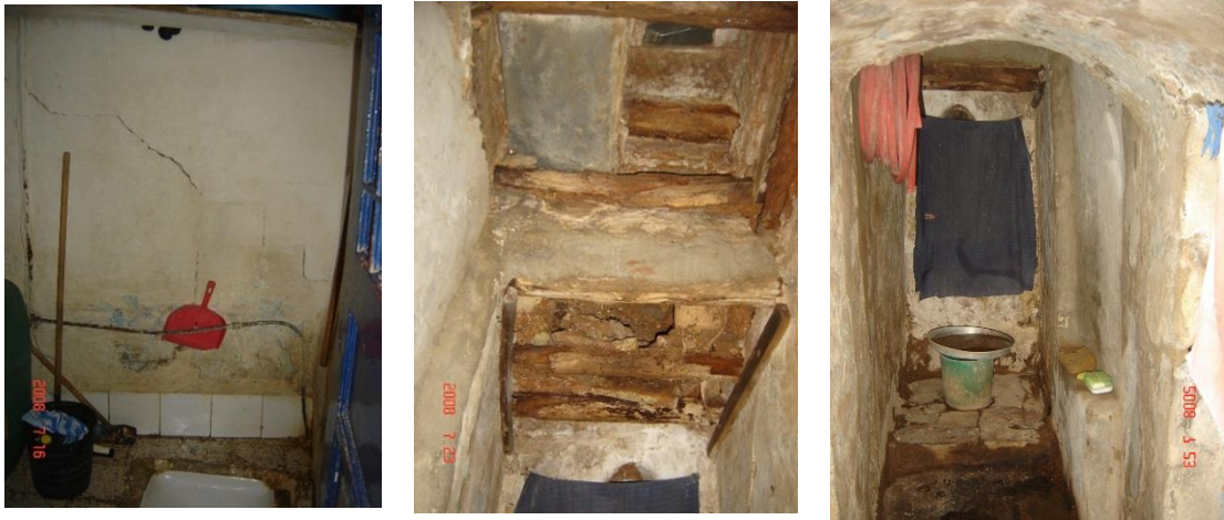
Figure 123 : les effets de l'eau sur les structures des maisons (Source : Auteure 2012)
