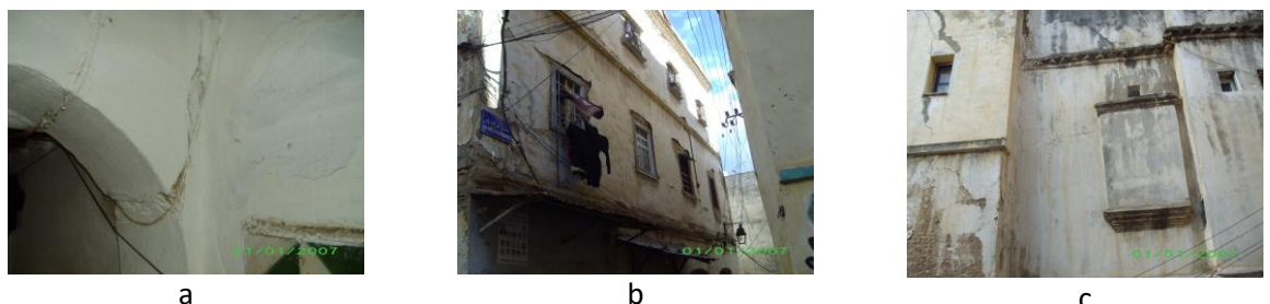
Figure 79 : Bâtisses classées vétuste du 2 nd degré (2007-2008) (Source : CEAT El Medina, 2022) a) 12, rue des frères Racim, b) 15, rue Boudries père et fils, c) 18, rue des frères Racim
