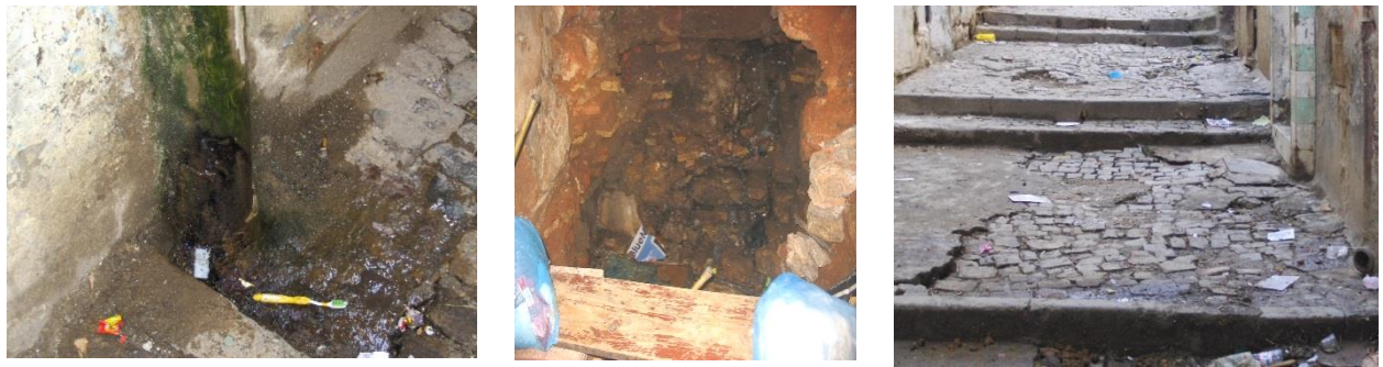
Figure 120 : Etat de la voirie et du réseau d'assainissement (Source Groupement CNERU 2007, 2010)
