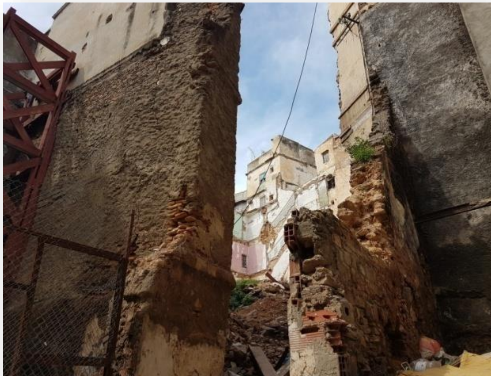
Figure 4 : Vue sur une bâtisse en ruine de la Casbah (15, rue des frères Boudriès) - Source : Auteure - juin 2023
