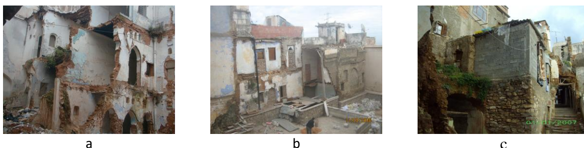
Figure 80 : Vues sur une bâtisse en ruine, un vide et une surélévation anarchique (a-Source Groupement CNERU 2007 , b et c (Source CEAT El Medina, 2007-2008)
