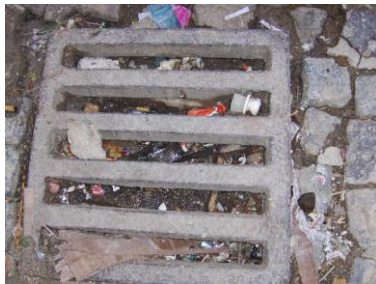
Avaloir bouché par des ordures – Photo prise en 2008 (Source : CEAT El Medina, 2022)
