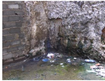
Stagnation des eaux usées – Rue Rabah Riah – 2007 (Source : Groupement CNERU 2007)
