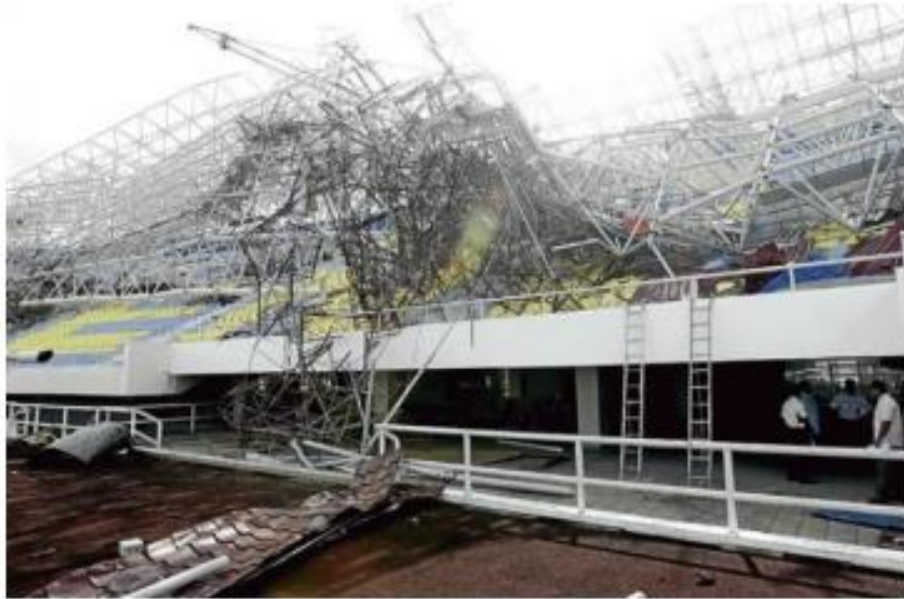
Fig 4.4 Effondrement du toit du stade Sultan Mizan Zainal Abidin [94].
