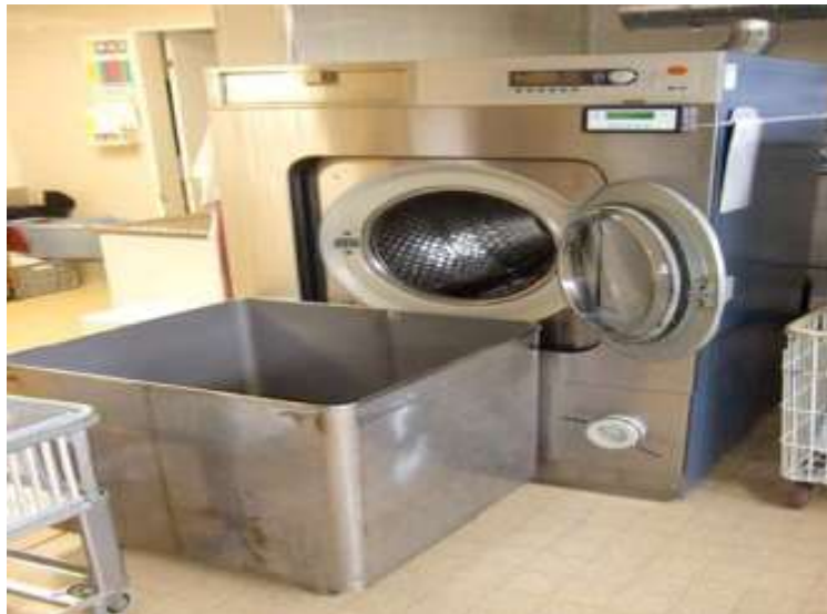
Figure 69 : Bacs à la hauteur des hublots.
