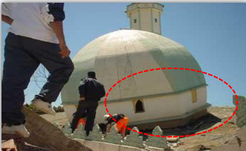
Figure 46: Effondrement total de plusieurs mosquées (Source : Rapport de la Protection civile de Boumerdes, 2003)
