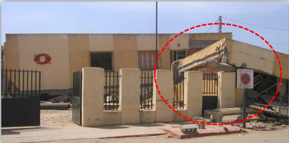
Figure 49 : Effondrement total d'un bureau de post et télécommunications à Zemmouri. (Source : (EERI 2003))
