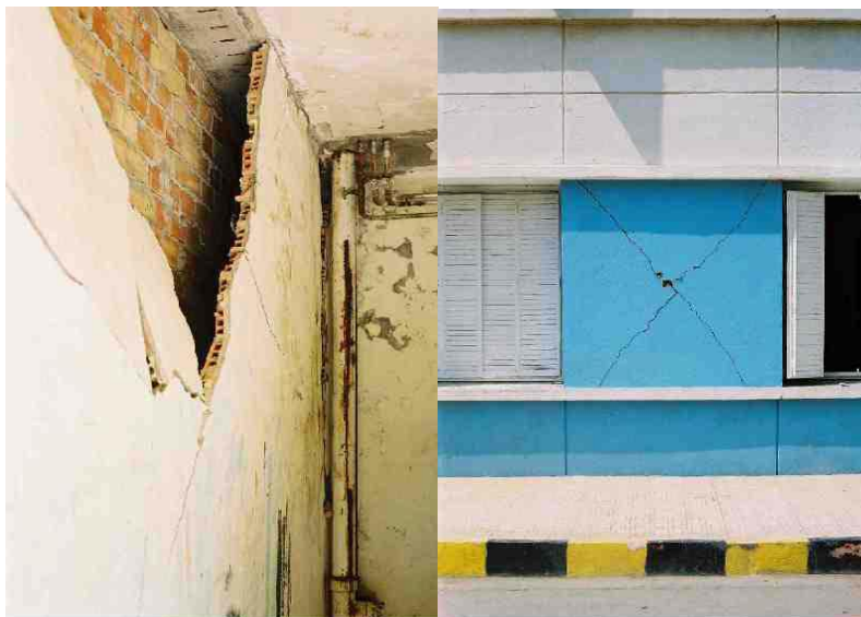
Figure 84: Fissures et effondrement des parois à l'hôpital de Dellys. (Source : (AFPS 2003))
