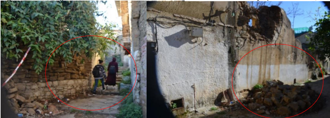
Figure 121: état dégradé des ruelles et la chute des murs à la basse Casbah de Dellys ( source : Sehili,2021)
