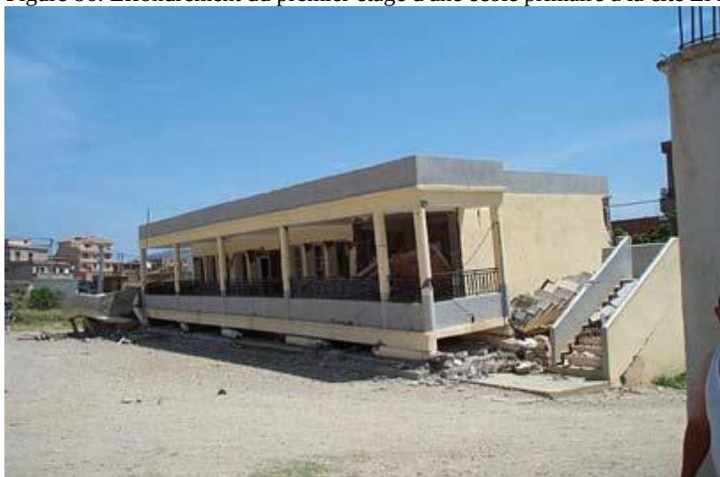
Figure 86: Effondrement du premier étage d'une école primaire à la cité El Mtal. (Source : Bechtoula 2003)
