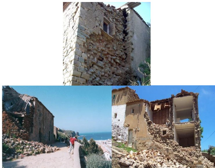
Figure 83: Endommagement des structures en maçonnerie. ( Source : BET Akretche)
