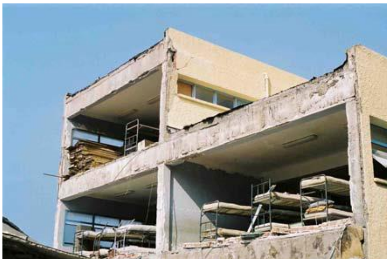
Figure 85: Effondrement total d'un bloc au collège Tobal .( Source : (Hakim Bechtoula 2003))
