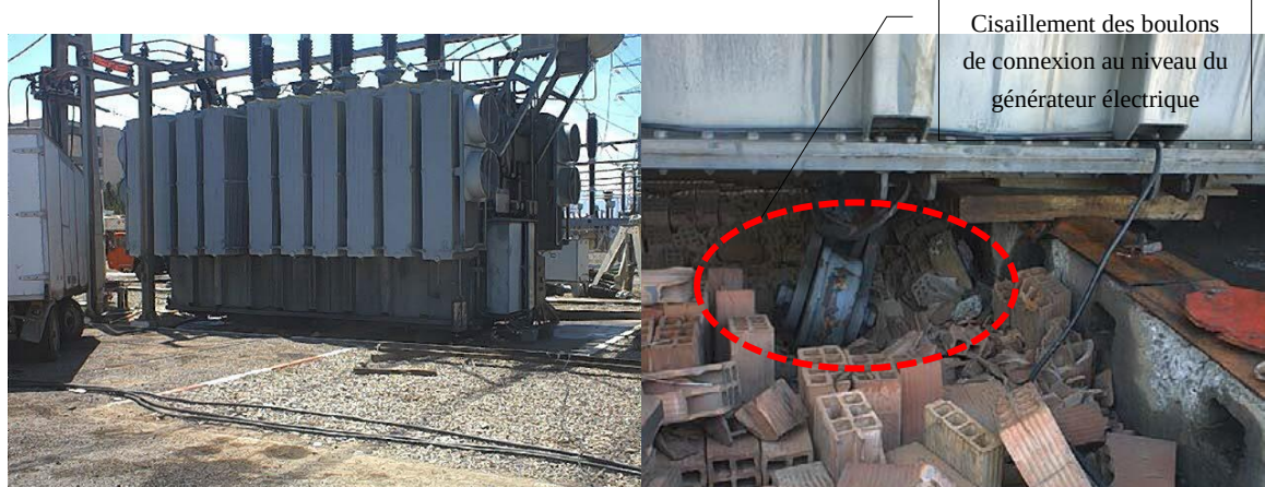
Figure 50 : Cisaillement des boulons de connexion au niveau du générateur électrique de Djinet (Source : Bechtoula, et Ousalem (2003))
