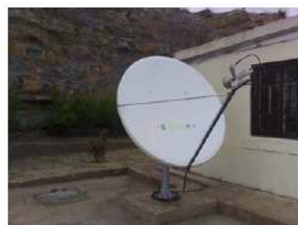
Figure III.9 : Transmission par satellite (VSAT) des données de la station vers le Datacenter (Alger).
