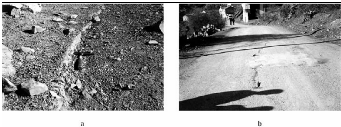
Figure II.34 : Les désordres géologiques sont remarqués près de scarp de cette faille, autour des villages de Tachaouaft, d'Aguemoun et d'Ighil Ouatou.
