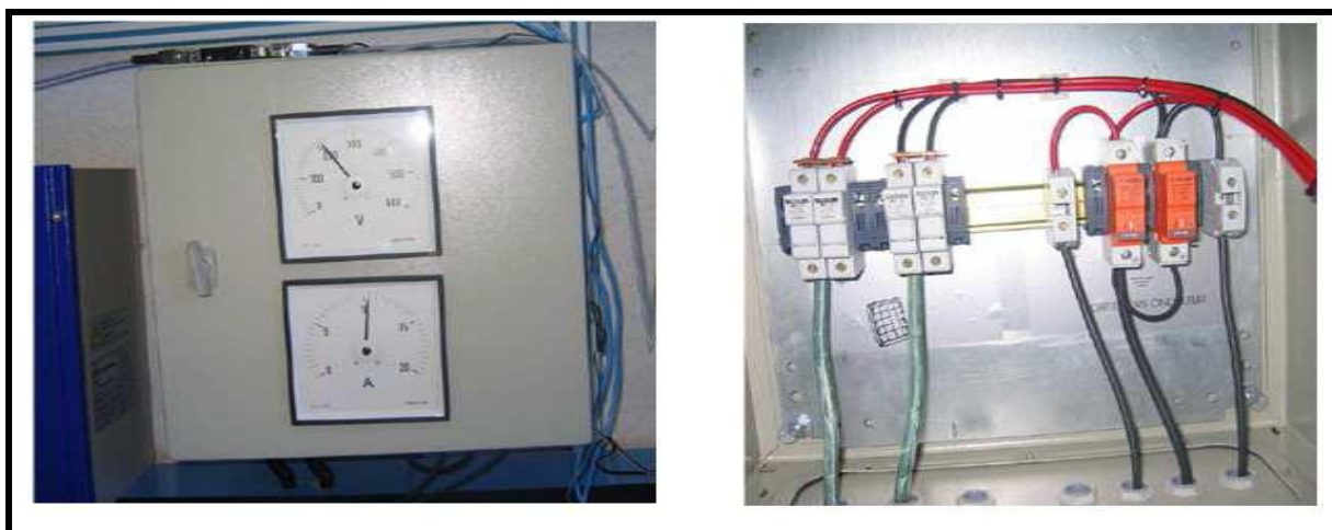
Figure A.5 : Photo de l'armoire DC
