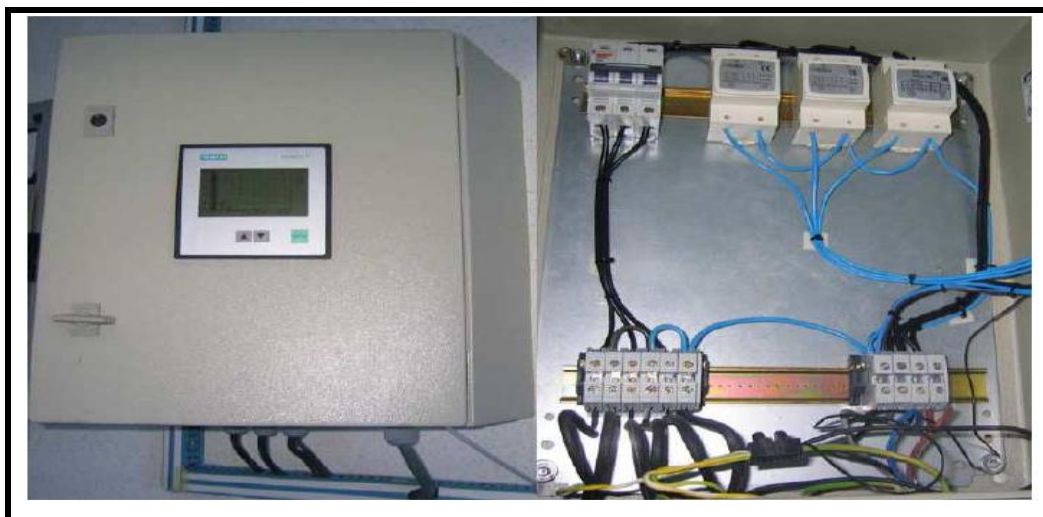
Figure A.8 : Photo de l'armoire de connexion.
