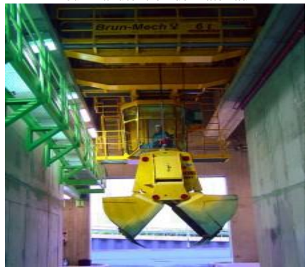
D - Pont roulant Pour les scories provenant d'incinération des déchets
