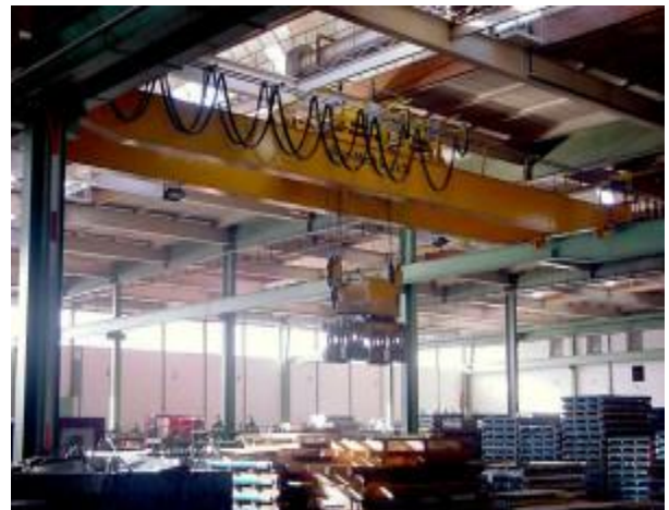
B - Pont roulant Pour manutention de matériaux
