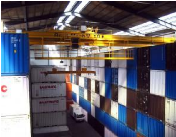
A - Pont roulant pour containers Halle de stockage
