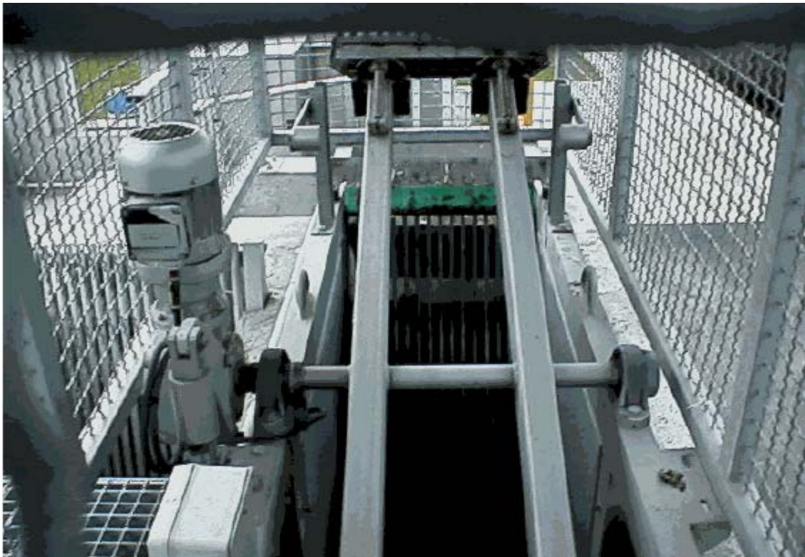
Figure 2.2 : Dégrilleur courbe d'une station d'épuration
