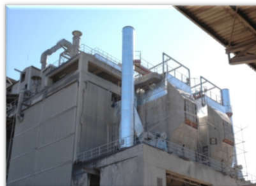
APRES « filtres à manches » [C] < 10 mg/Nm 3
